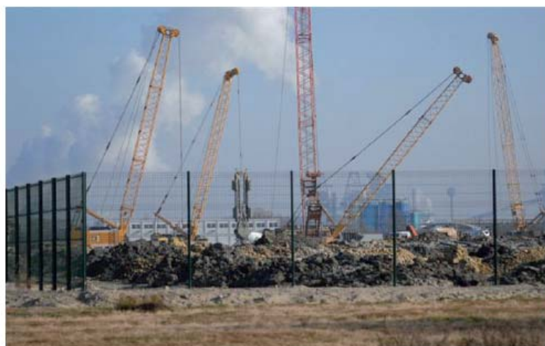
Janvier 2007, des équipes espagnoles se relayent sur le chantier jour et nuit.
